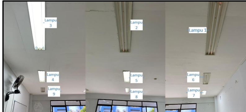
Gambar 4. 23 Kondisi Lampu TL Atau Lampu Neon
