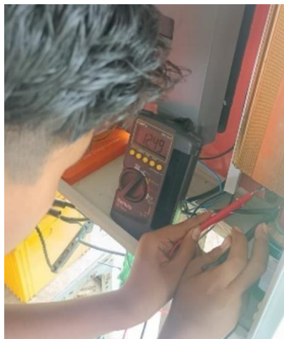
Gambar 4 11 Pengukuran Tegangan Dari SCC Ke Inverter
