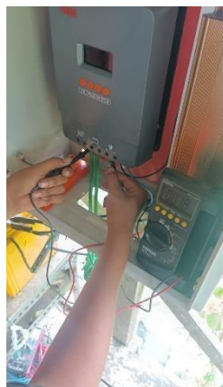
Gambar 4 10 Pengukuran Arus Dari Baterai Aki Ke SCC
