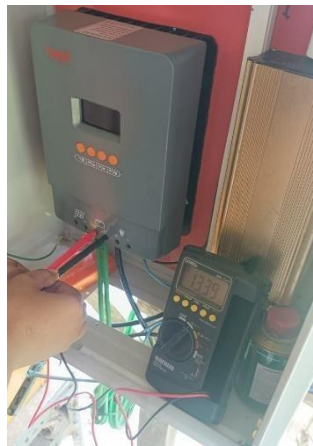
Gambar 4 9 Pengukuran Tegangan Dari Baterai Aki Ke SCC
