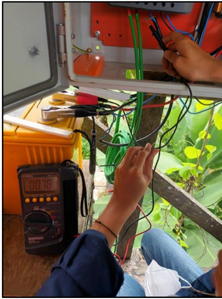
Gambar 4.17 Pengukuran Arus Dari Generator Ke Aki
