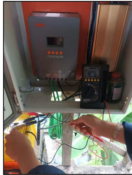
Gambar 4.18 Pengukuran Tegangan Dari Generator Ke Aki
