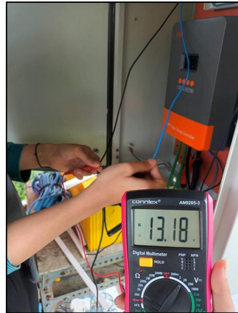
Gambar 4.11 Pengukuran Tegangan Output Generator DC
