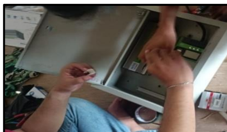
Gambar 4. 2 Wiring Pada Panel Box
