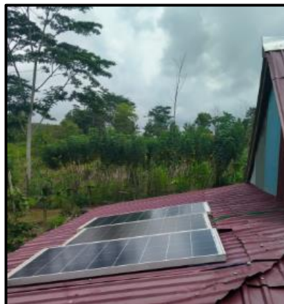
Gambar 4. 6 Panel Surya Yang Sudah Terpasang
